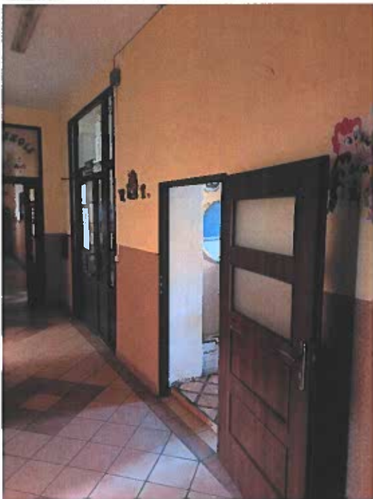
Zdjęcie nr 2 – wejście do pomieszczenia na parterze w części „A” przeznaczone na szymb dźwigu
