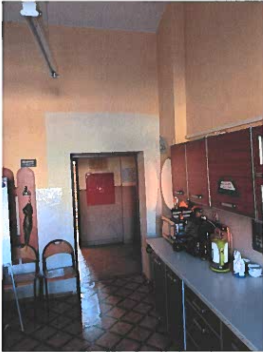
Zdjęcie nr 1 – pomieszczenie na parterze w części „A” przeznaczone na szymb dźwigu
