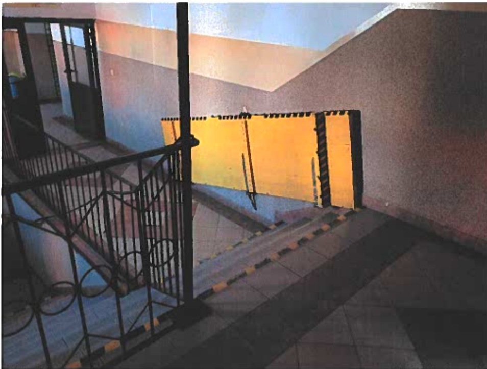
Zdjęcie nr 11 – schody pomiędzy częścią „A” a częścią „B” do dostosowania do komunikacji dla niepełnosprawnych
