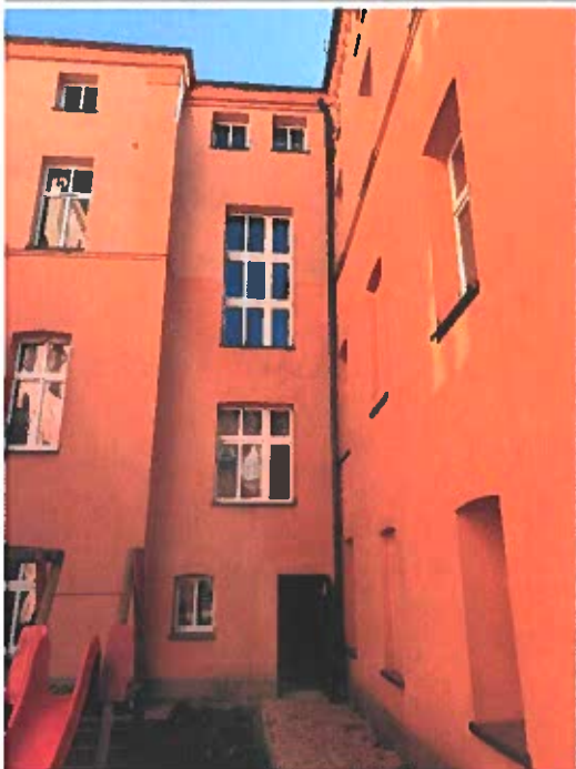
Zdjęcie nr 4 – widok na elewację budynku dla lokalizacji szybu zewnętrznego dźwigu osobowego
