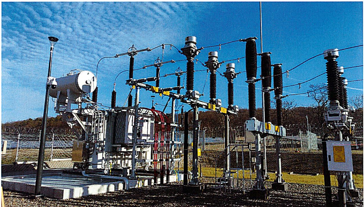
Zdjęcie nr 2. Stacja 110/30 kV GPO PV Lipa – widok fragmentu obiektu.
